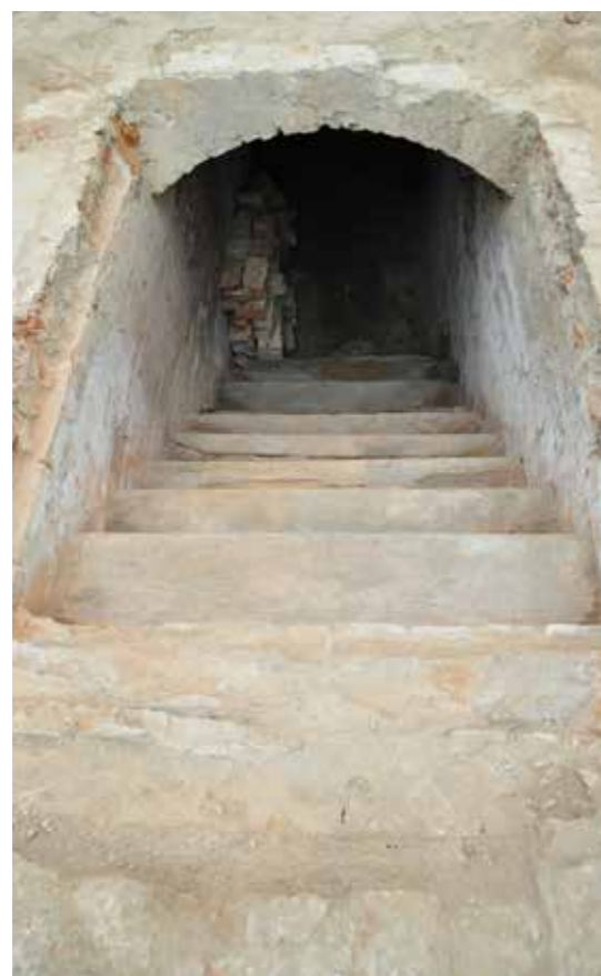
Ryc. 1.4. Uszkodzona oryginalna klatka schodowa z XVIII wieku. Widok w czasie remontu w 2015 roku. Fot. S. Gołub
