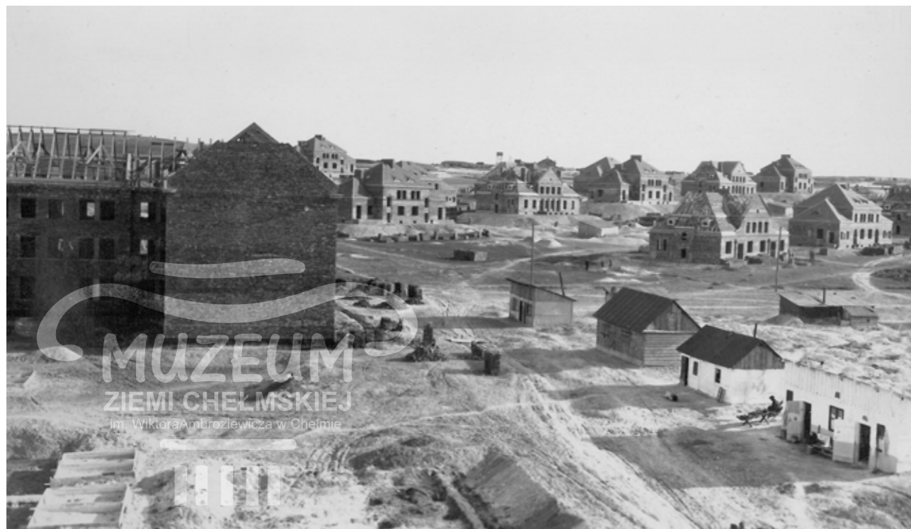
Widok na gmach Dyrekcji Kolei Państwowych w Chełmie i ul. George'a Stephensona; 1929 r. w: Album pamiątkowy z budowy osiedla kolejowego i Dyrekcji w Chełmie zbiory: Stacja Muzeum w Warszawie, arch. 1420.
