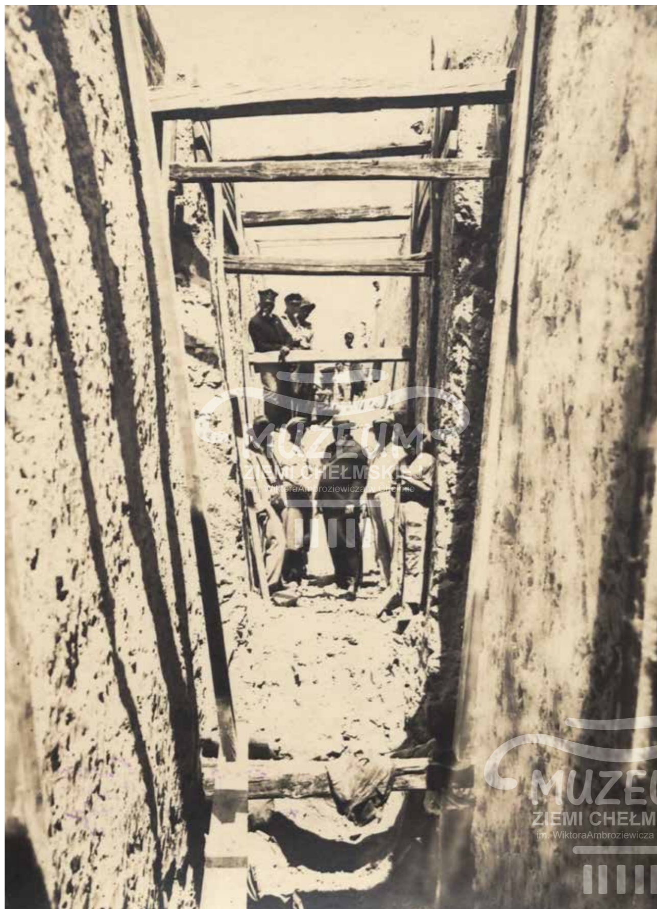
Układanie przewodów kanalizacyjnych na terenach budowy gmachu Dyrekcji Kolejowej i Kolonii Mieszkalnej zbiory: Wojewódzka Biblioteka Publiczna im. Hieronima Łopacińskiego w Lublinie, sygn. 1873/II (5059/1).
